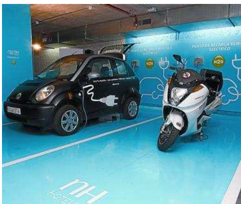
Punts de recàrrega elèctrica a l'hotel NH Constanza de Barcelona. Foto: SERGIO LAINZ
