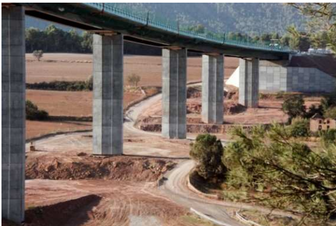
Una de les obres que té més impacte visual és el viaducte que passa per sobre la riera de Rajadell. Foto: Estefania Escolà
